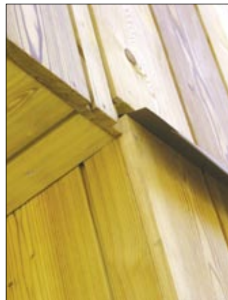
Foto 5. Fotol 4 kujutatud maja uke kohal olev aste. Õhu juurdepääs tuulutusvahesse on suletud. Voodrilaudade jätkamine veepleki abil pikkuses (ülemine ots on vee eest kaitstud) on korrektne, kuid laudade alumised otsad on jäetud veeninaks saagimata (vt fotod 14 ja 15). Tuleb jälgida, et veeplekk ei katkestaks tuulutusvahet (kui roovitis on paigaldatud fotol 1 näidatud või muul sarnasel viisil, ei sega roovi külge kinnitatud veeplekk tuulutust).
